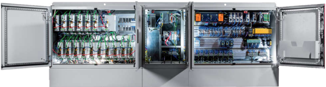
Blick in den neuen kompakten Schaltschrank
